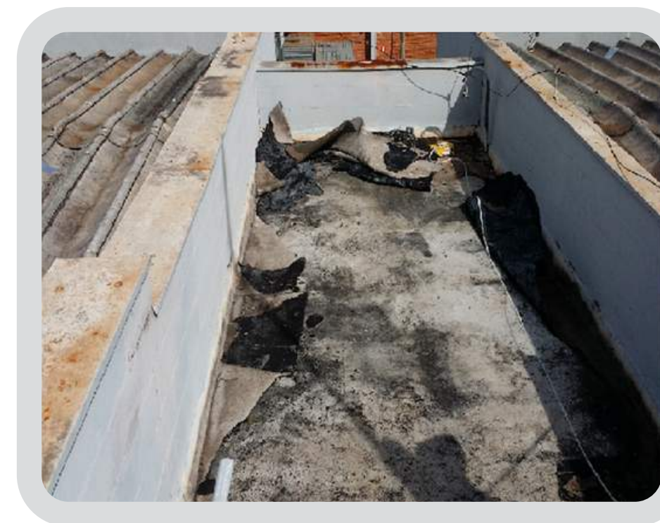
Manta asfáltica de impermeabilização toda solta antes da reforma
